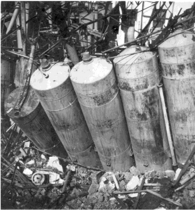
Boven: de carbonatatieketels waren in de machinekamer gevallen
